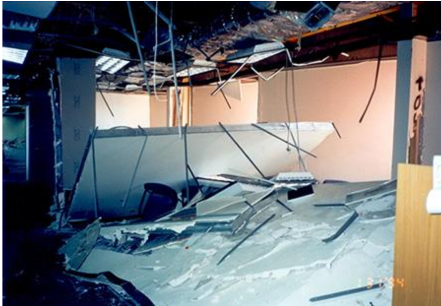
Figura 1.6 Deformación excesiva del marco estructural, caída de muro divisorio
