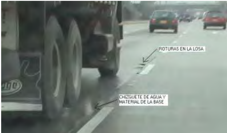
Foto 3.8.b.1 Bombeo en pavimento rígido.
