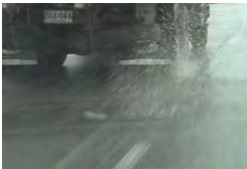
Foto 3.8.b.2 Aumento de daño por bombeo.
