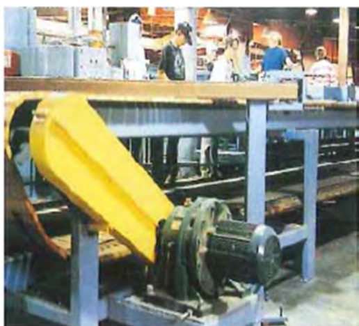
Figura 1.10. Industria de la madera: Reductores para accionamiento del transportador. La gran capacidad de sobrecarga, funcionamiento sin mantenimiento y seguridad contra las averías fueron ventajas decisivas.
