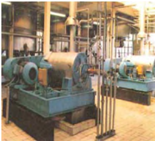
Figura 1.13. Tratamiento de mezclas (soluciones): control de centrifugadoras de decantación
