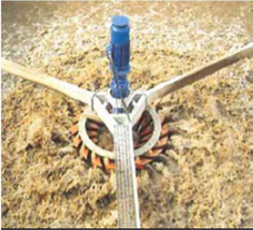
Figura 1.11. Planta depuradora: diseño compacto, capacidad de absorción de impactos y mínimo mantenimiento.
