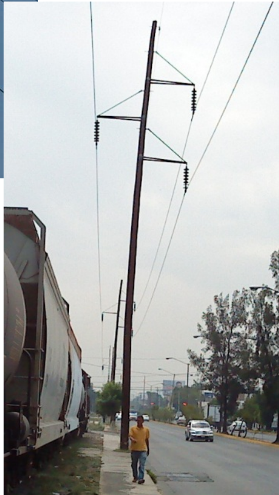
Imagen 3.8.- Deflexión de postes de madera por desgaste natural
