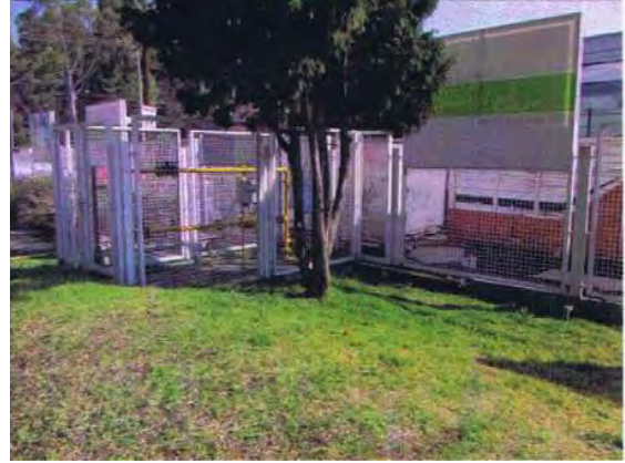
Depósito e instalación de gas natural
