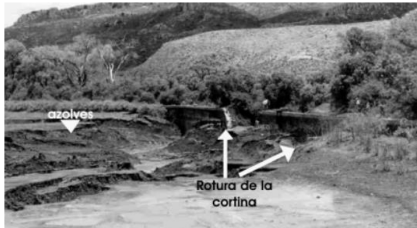
Figura 1.12 Falla de la presa El Capulín. Vista de los azolves.
