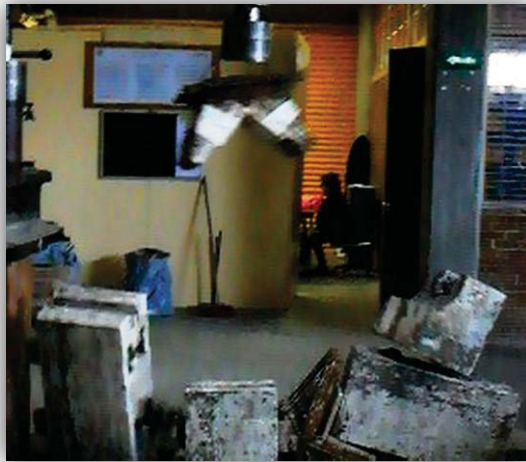
Colapso del murete 1.
