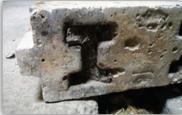
Pieza fallada. Se observa que uno de los botones de ensamble fue capado.
