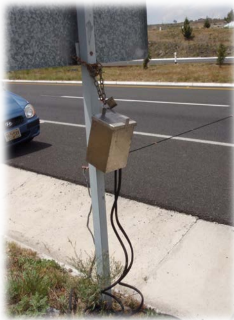
Figura 18. Mangueras debidamente conectadas en la Caja Metálica
