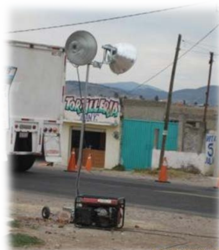
Figura 14. Planta de energía
