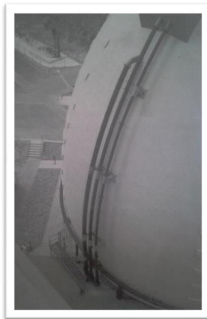
Figura 3.2 Uno de los digestores de la planta de Perth (Sims, 2002).
