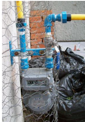
Figura 4.8 Medidor de gas (Juárez, 2012)
