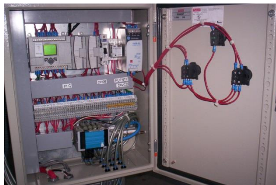
Figura 3.26. Tablero de Control del dispositivo
