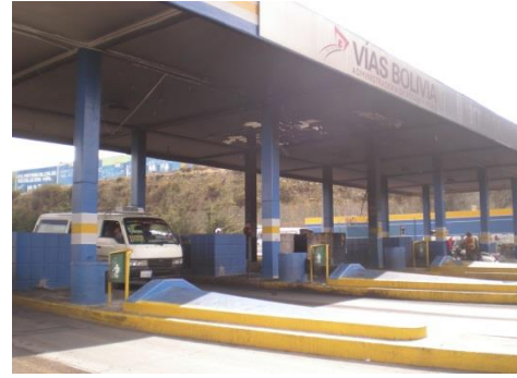
Peaje de autopista La Paz-El Alto totalmente destruido, 29 de diciembre de 2010. (foto no. 12)
