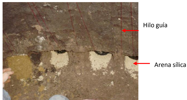
Figura 9. Contenedores de resina instalados.
