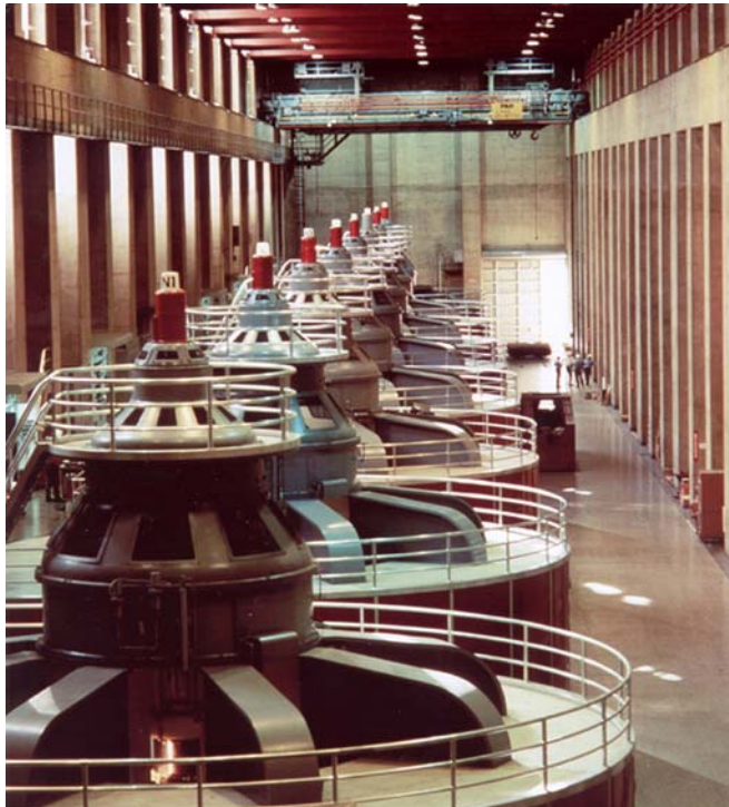
Figura 2.1. Arreglo de Generadores eléctricos Verticales.
