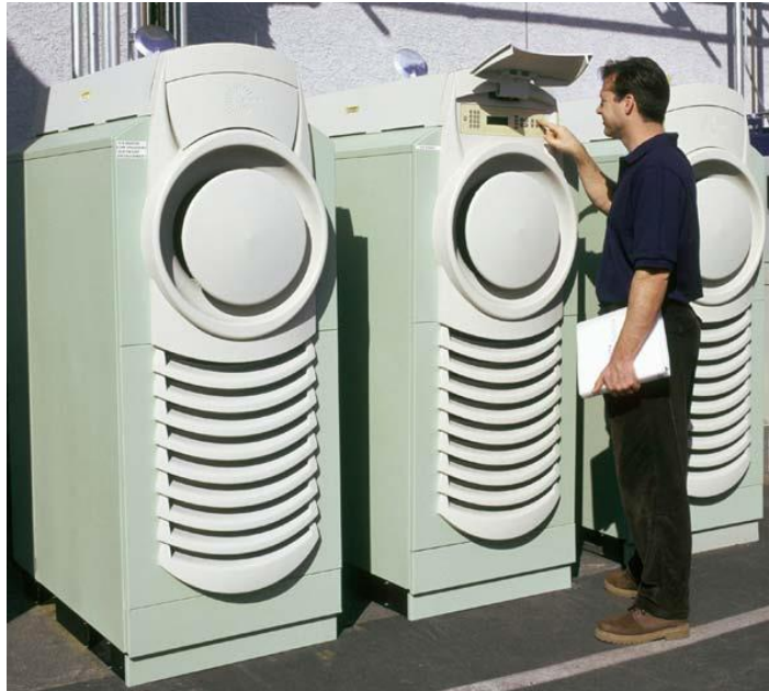
Figura 0 . Arreglo en serie de microturbinas gas
