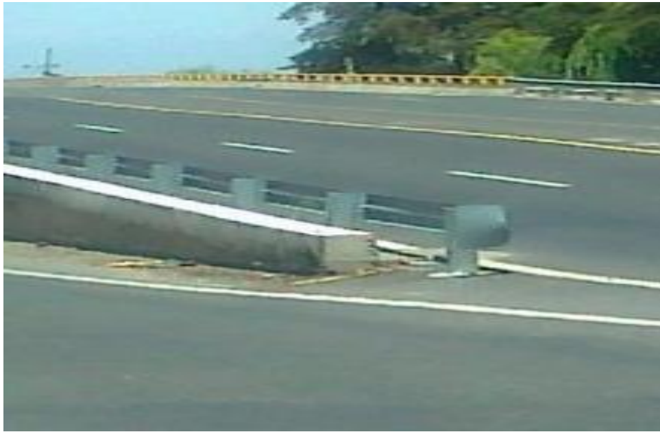
Fig. I.5.8 Barreras de protección a la salida del puente vehicular.
