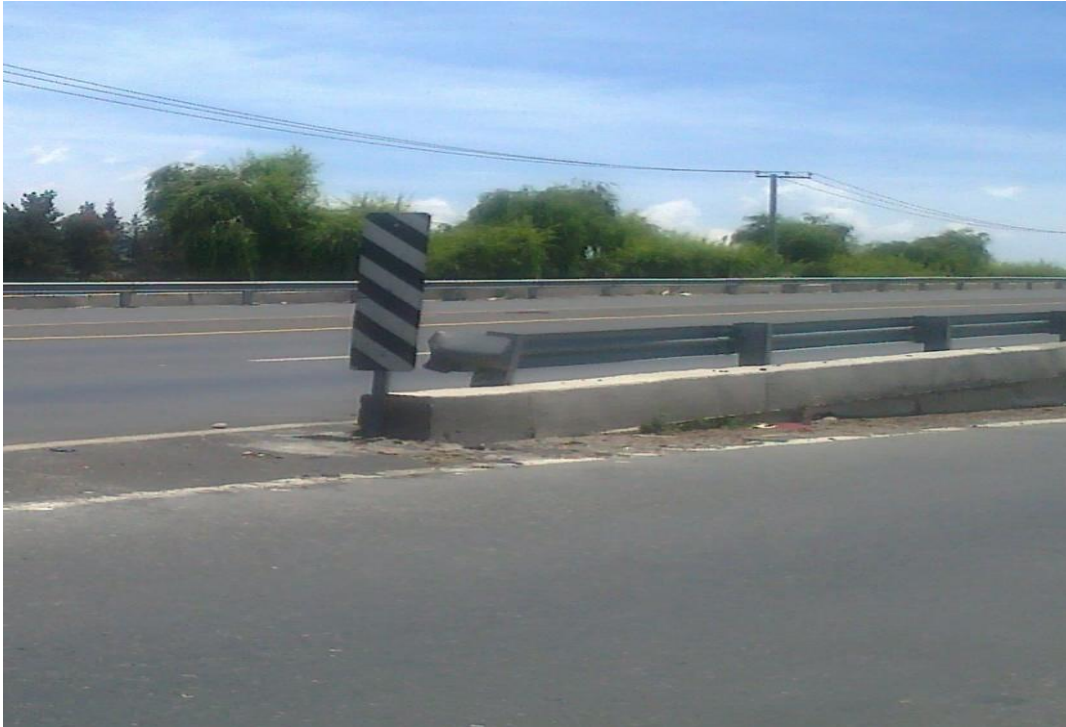
Fig. I.5.10. Defensas metálicas galvanizadas.
