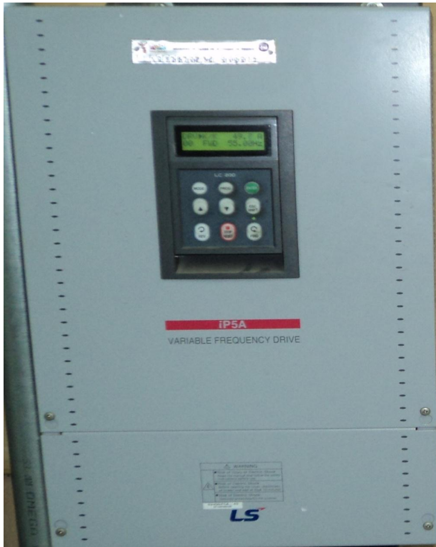
Fig. 2.23 Variador de Frecuencia a 48 Hz.
