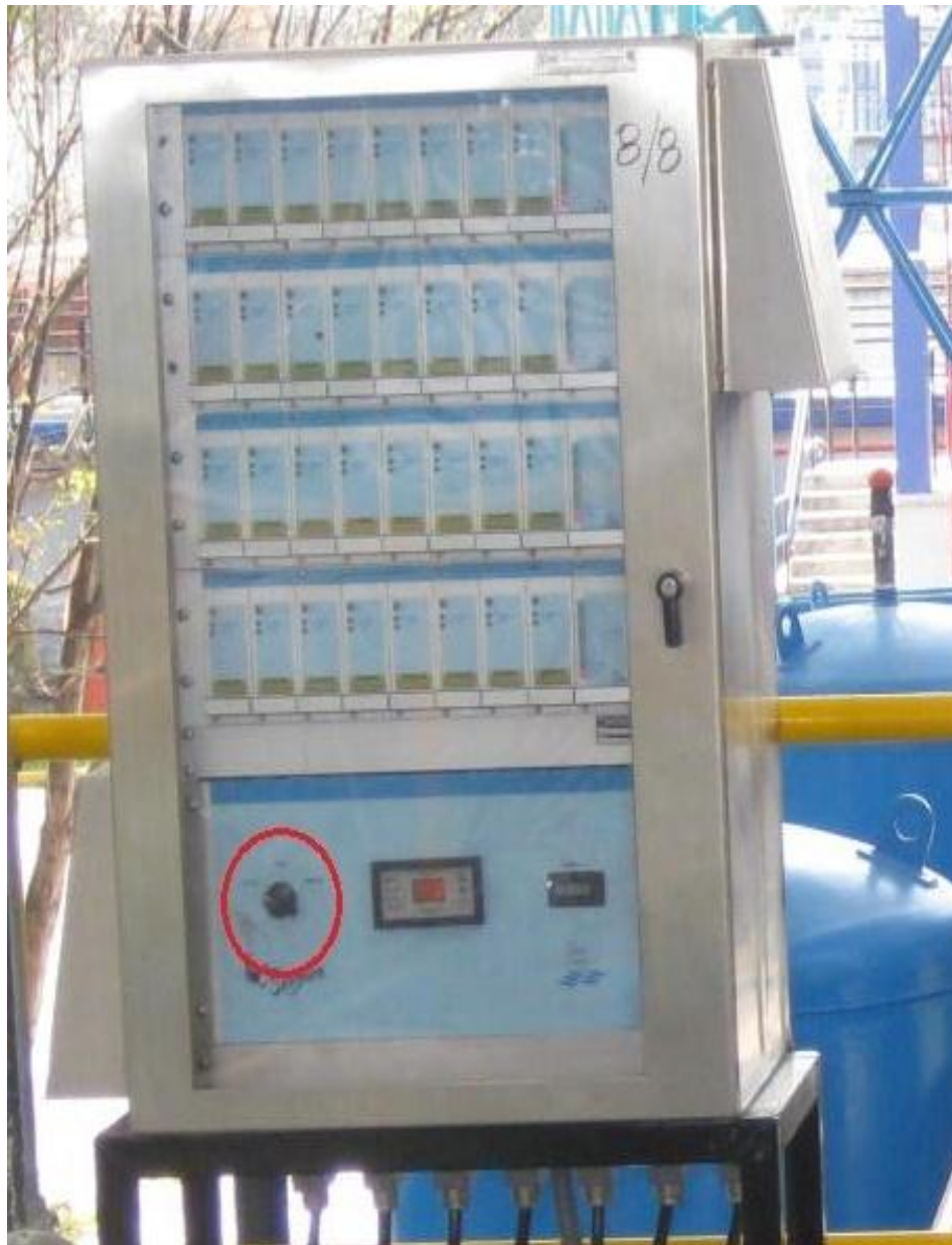
Fig. 2.26 Tablero de Control de Luz Ultravioleta.
