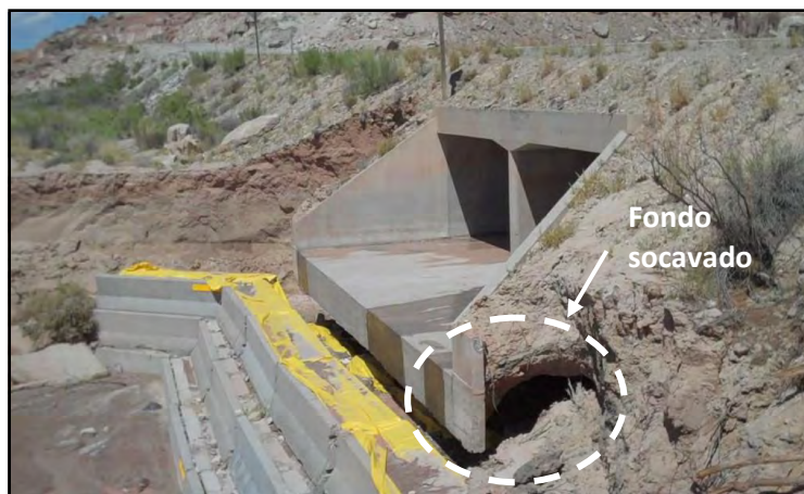
Figura 16. Socavación del material debajo de la alcantarilla tras una avenida repentina.
