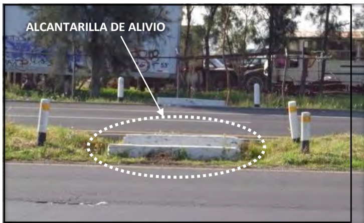
Figura 27. Luis Carlos Moreno Padilla, En esta fotografía se muestra una alcantarilla de alivio ubicada en el camellón central de la Autopista Peñón-Texcoco, para desalojar el exceso de agua que pudiera acumularse en la carpeta asfáltica., Texcoco Edo. de México, octubre de 2012.
