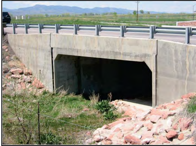
Figura 23. Imagen en la que se observa una alcantarilla de cajón de concreto reforzado, con sus bordes de entrada biselados. Imagen tomada de: Referencia bibliográfica No. 6
