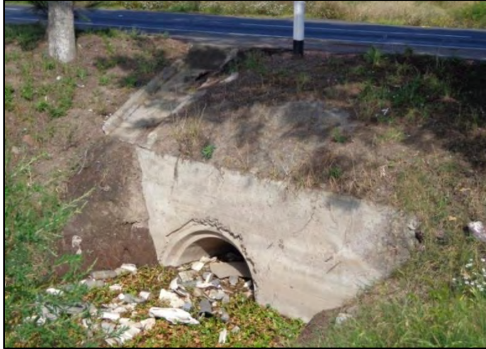
Figura 14. Luis Carlos Moreno Padilla, En esta fotografía se ve una alcantarilla que no cuenta con una barrera contra basura, necesaria para impedir el paso de basuras y escombros al cañón de la misma, reduciendo así su capacidad hidráulica. Autopista Peñón-Texcoco, Texcoco Edo. de México, octubre 2012.
