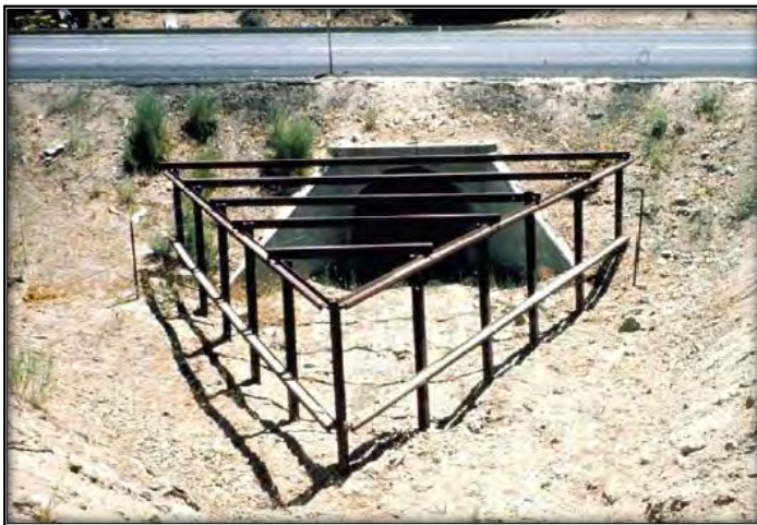
Figura 15. El uso de rejillas en las alcantarillas evita la acumulación de escombros a la entrada de la alcantarilla. Imagen tomada de: Referencia bibliográfica No. 6
