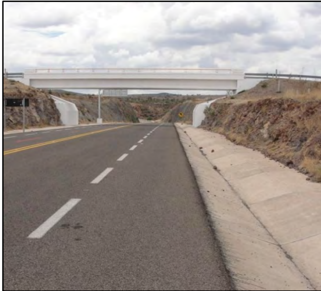
Figura 3. M. en I. Arroyo Hernández Patrocinio, En esta fotografía se observa una cuneta que forma parte del drenaje longitudinal de la Autopista Durango-Mazatlán, julio 2012.
