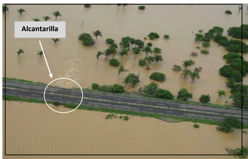
Figura 58. En esta fotografía se observa una alcantarilla trabajando a presión. Autopista La Tinaja – Sayula, Tramo Cosamaloapan – Sayula. Estado de Veracruz. Imagen tomada del sitio: http://www.slideshare.net/angelarmengol/danos-carreteras-veracruz-sct (Fecha de actualización: 9 de Enero de 2013).
