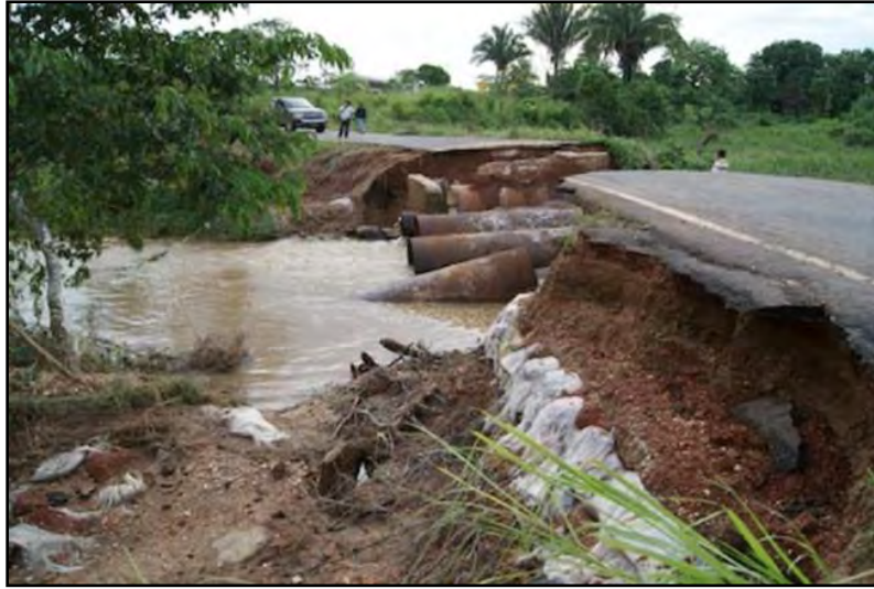
Figura 17. Falla estructural de una alcantarilla de batería múltiple de tubos. Imagen tomada del sitio: http://www.jornadaveracruz.com.mx/Noticia.aspx?ID=101006_141732_591 (Fecha de actualización: 16 de Octubre 2012)
