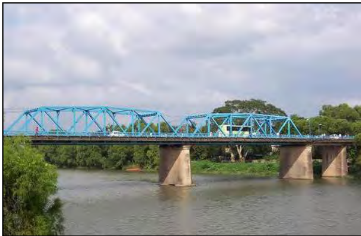
Figura 7. Anónimo, Puente Martínez I, En el Municipio de Martínez de la Torre Veracruz. El uso de puentes es frecuente para cruzar grandes claros impuestos por la topografía del terreno y grandes cauces.
