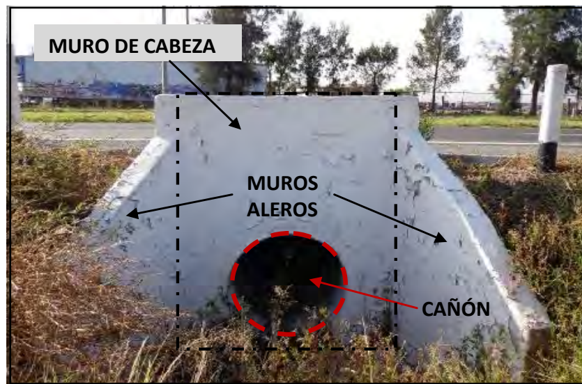
Figura 10. Luis Carlos Moreno Padilla, En esta fotografía se muestra una alcantarilla en la que se aprecian las partes principales que la componen. Autopista Peñón-Texcoco, Texcoco Edo. de México, octubre 2012.
