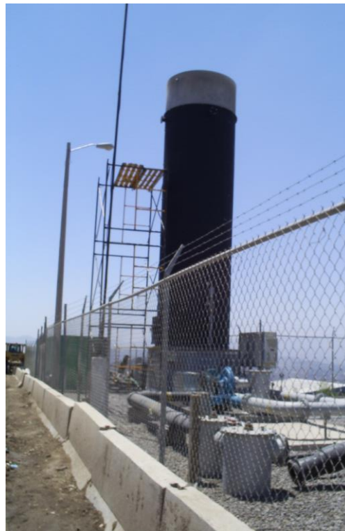
Fotografía 1. Sistema de quemadores de biogás instalados en SDF de Ecatepec
