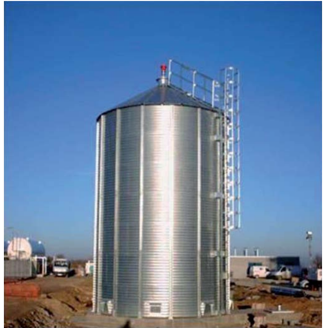
Fig.7 Tanque de tratamiento lixiviados. Fuente: http://www.aqualimpia.com
