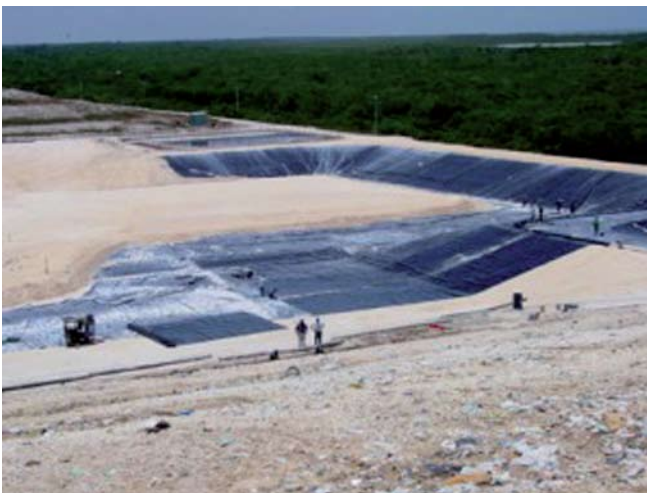
Fig.5 Construcción de un relleno sanitario en la etapa de colocación de la membrana plástica. Fuente: http://www.dforceblog.com
