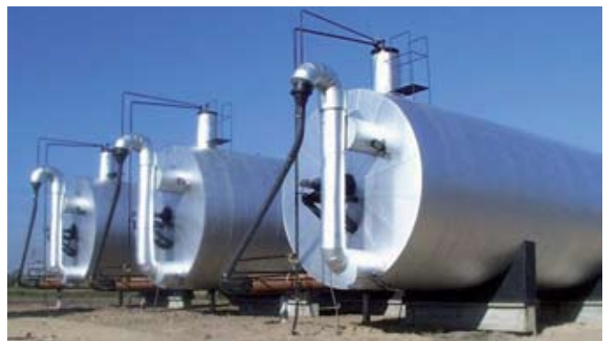
Fig.9 Planta de tratamiento de biogás. Fuente: http://www.redbiogas.cl
