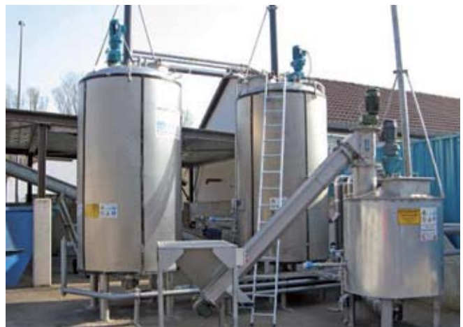
Fig.8 Planta de tratamiento de biogás. Fuente: http://www.redbiogas.cl
