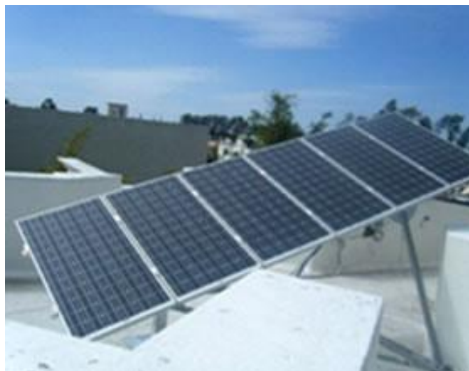
Figura 19 - Instalación Fotovoltaica 45 tipo Tracker por Desmex Solar: 1.05 kW
