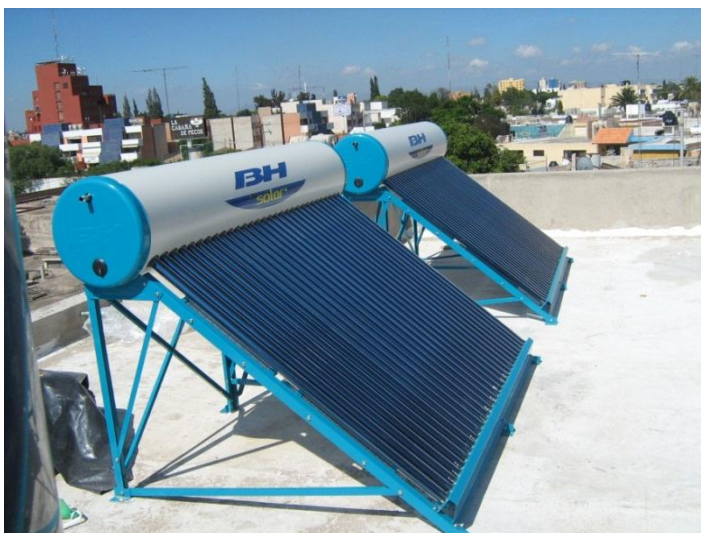
Figura 22 - Colectores de tubos evacuados 48 .
