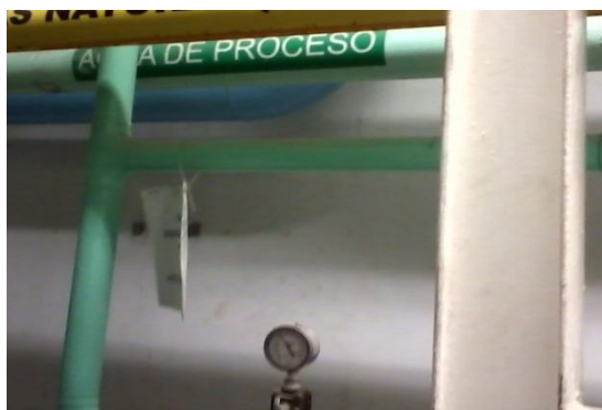
Figura 1. Identificación de tubería de agua Viridiana Martínez
