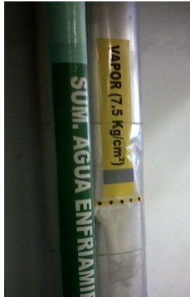
Figura 3. Identificación de tubería de vapor Viridiana Martínez
