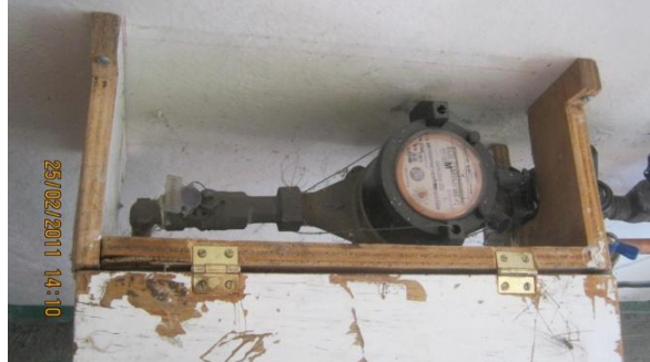
25/febrero/2011 Puente Blanco, Iztapalapa, DF. Medidor resguardado de nietos
