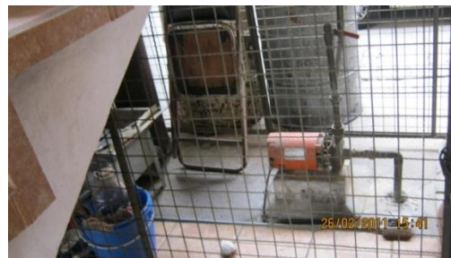
26/febrero/2011 Pedregal del Maurel, Coyoacán, DF. Cisterna y bomba
