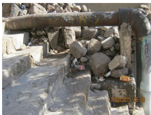
17/febrero/2011 Tlalpexco, GAM, DF. Tubería improvisada en escaleras de la calle
