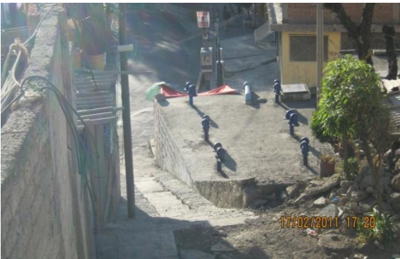
17/febrero/2011 Tlalpexco, GAM, DF. Tubería vecinal entre escaleras
