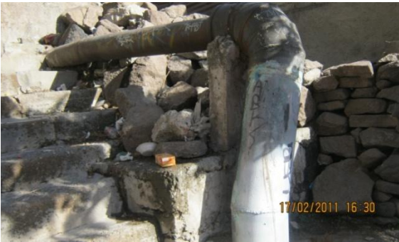
17/febrero/2011 Tlalpexco, GAM, DF. Fugas por infraestructura
