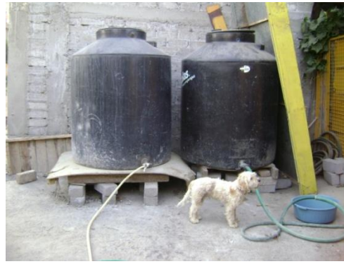
14/febrero/2011 Valle de las Luces, Iztapalpa, DF. Tinacos con conexión y manguera
