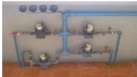
26/febrero/2011 Pedregal del Maurel, Coyoacán, DF. Medidores por piso de edificio
