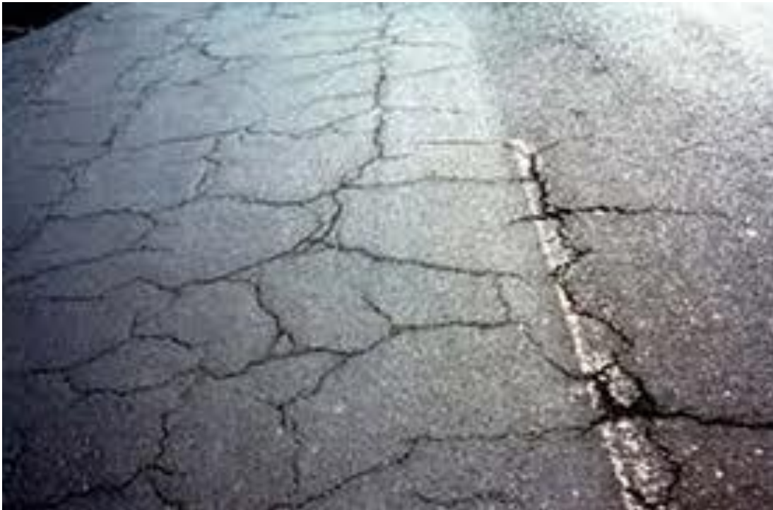
Imagen 8. Agrietamiento en forma de piel de cocodrilo
