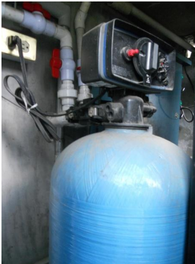
Figura 3.10 Detalle del equipo de filtración.
