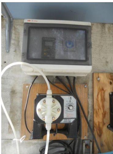
Figura 3.9 Bomba de diafragma utilizada para la dosificación de hipoclorito de sodio.
