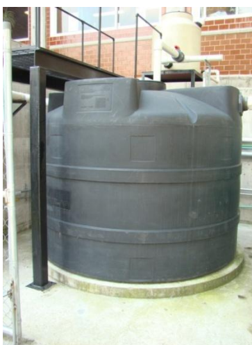
Figura 3.3 Tanque Séptico y biofiltro (en segundo plano) de la PTAR.
