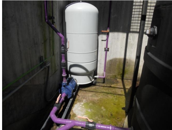
Figura 3.13 Bomba centrífuga e hidroneumático.
