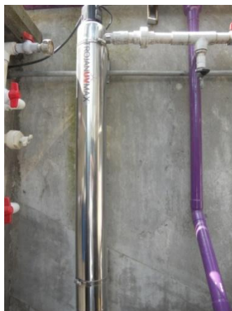
Figura 3.12 Lámpara UV utilizada en la PTAR.
