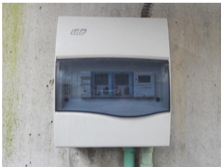
Figura A4.1 Tablero de control.
