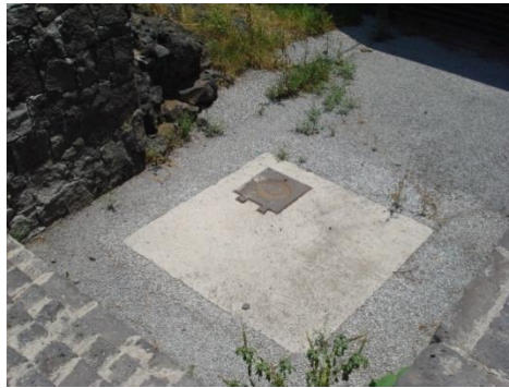
Figura 3.2 Cárcamo de bombeo de la PTAR.
