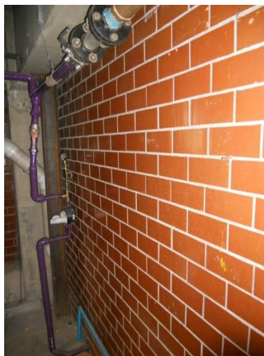
Figura 3.15 Arreglo de tubería en el interior del edificio.
