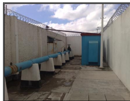
Fig. 3 Pozo 2 Ramal los Reyes Ecatepec
