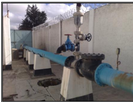
Fig. 2 Pozo 1 Ramal los Reyes Ecatepec
