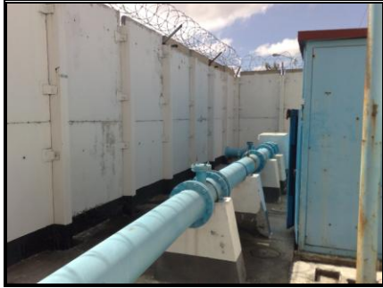
Fig.6 Pozo 5 Ramal los Reyes Ecatepec
