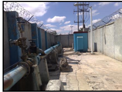
Fig.7 Pozo 6 Ramal los Reyes Ecatepec
