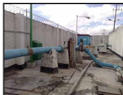
Fig. 5 Pozo 4 Ramal los Reyes Ecatepec
