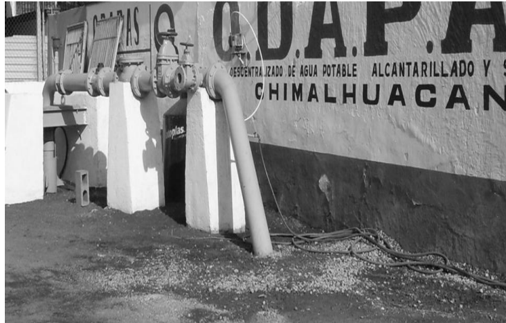
Foto II-1. Pozo profundo de agua potable con bomba submarina a 150.00 m de profundidad, ubicado en Av. Bordo Xochiaca, esq. Av. Del peñón, municipio de Chimalhuacán.
