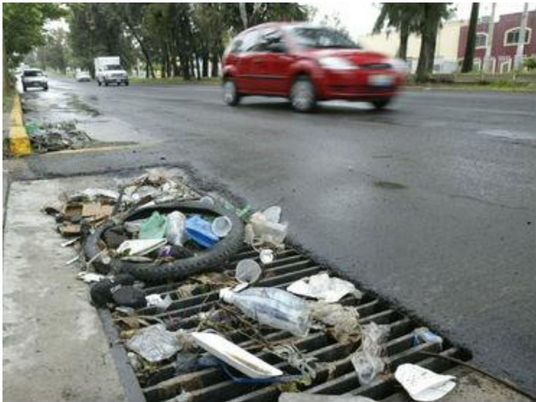
Obstrucción con basura de rejilla boca de tormenta.
