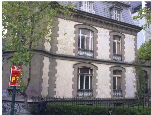
Figura 48 La misma mansión de la figura anterior en otra vista, se pueden observar las ventanas que están clausuradas, el inmueble se encuentra en desuso. Imagen: Propia de la autora.
