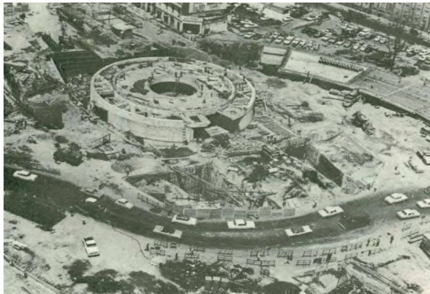
Figura 30 Construcción de la estación del metro Insurgentes, 1969. Imagen: Memoria Metro de la Ciudad de México.
