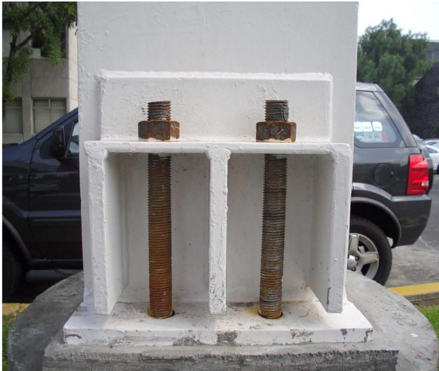
Placa base con atiesadores para reducir el giro por momento así como espesor de la placa base
