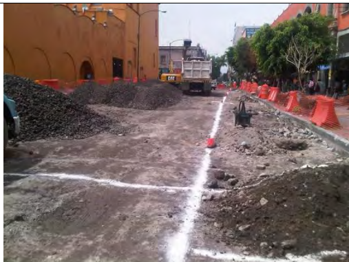
Se observa el trazo de la trayectoria de la línea de drenaje.
