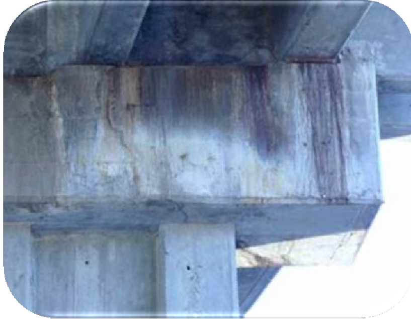
Fig. 63 Detalle de cabezal lado izquierdo donde se observan manchas de humedad y oquedades.
