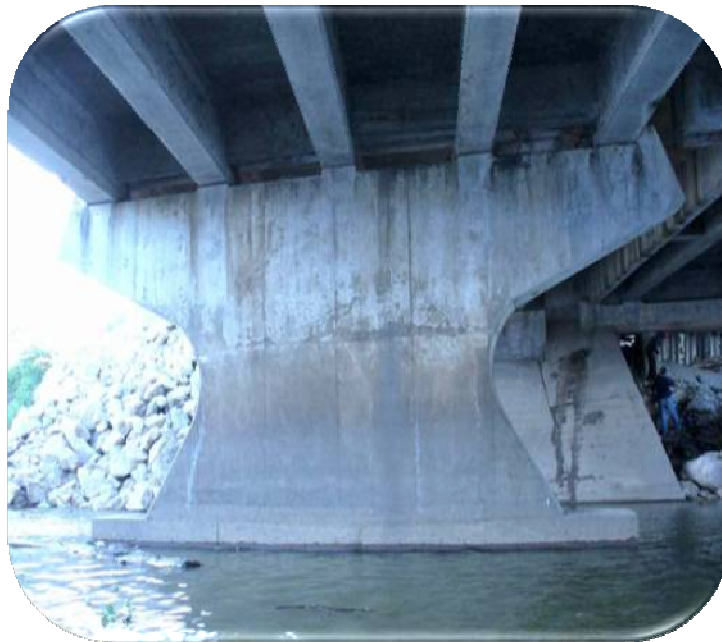
Fig. 58 Vista de pila eje 2 cuerpos "B" donde se observan manchas de humedad A causa del escurrimiento sobretodo en la parte del cabezal
