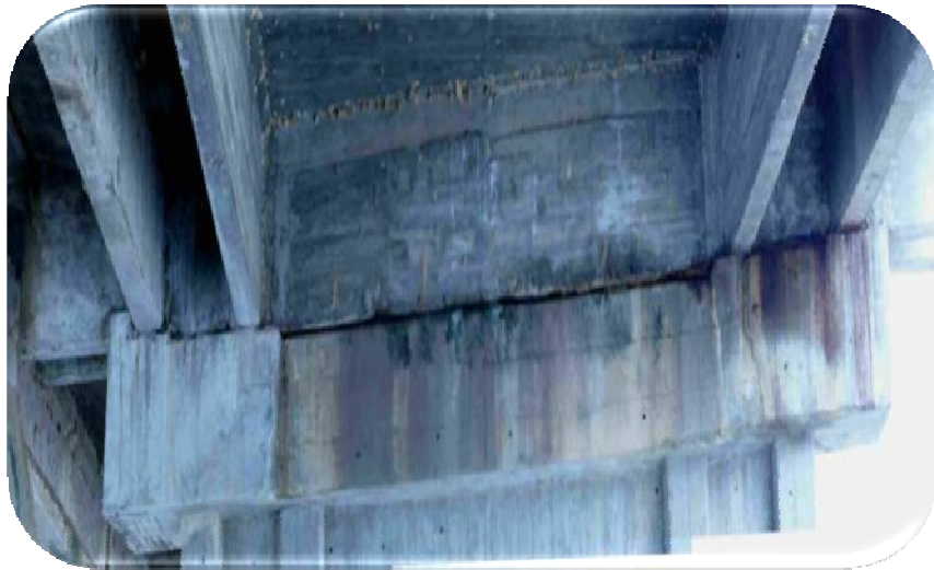
Fig. 62 Detalle de cabezal en pila 3 con manchas de humedad.
