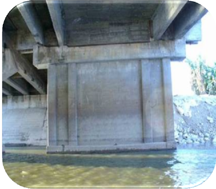
Fig.59 Cuerpo "B" con manchas de humedad
