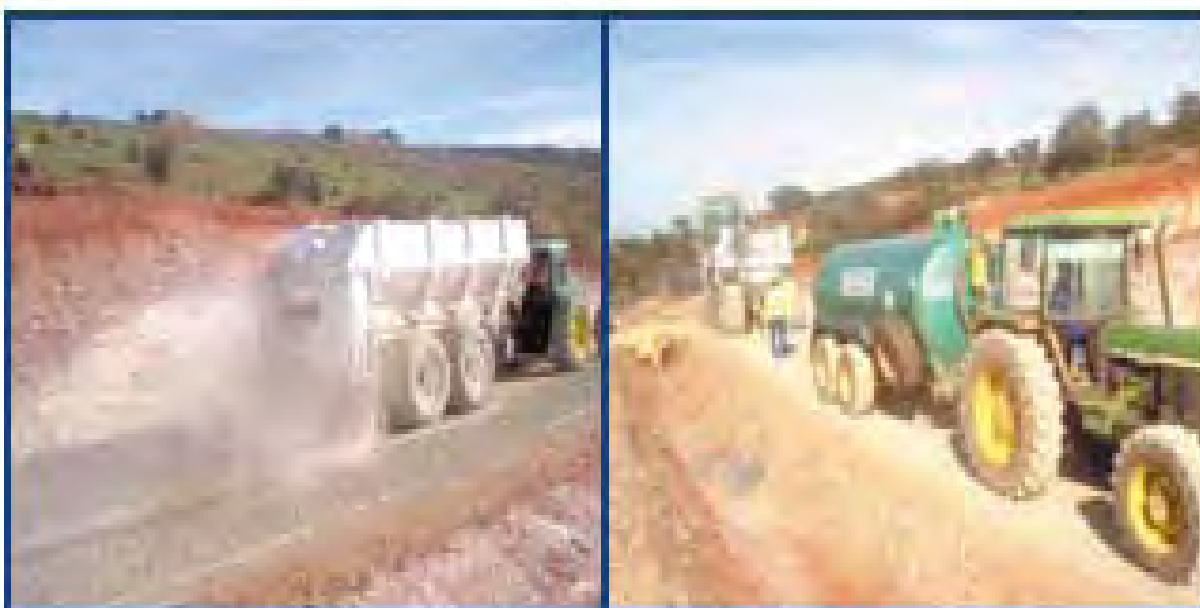
Fig. IV.3.2.- Extendido de cemento (izq.) y tren de reciclado in situ enganchado a tractor cuba (der.)
