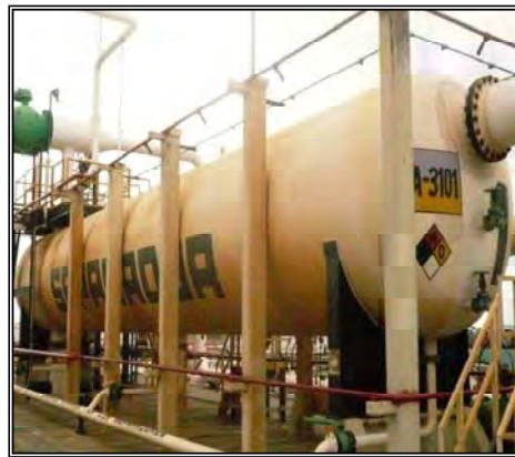
ASPECTO GENERAL DEL EQUIPO
