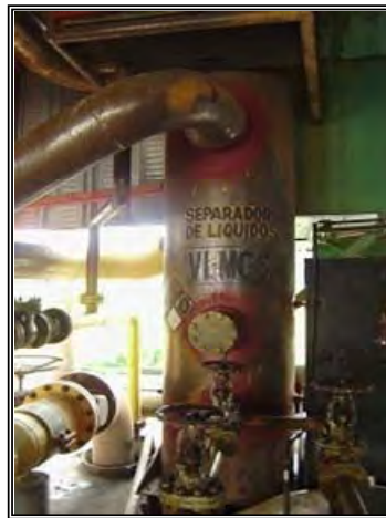
ASPECTO GENERAL DEL EQUIPO
