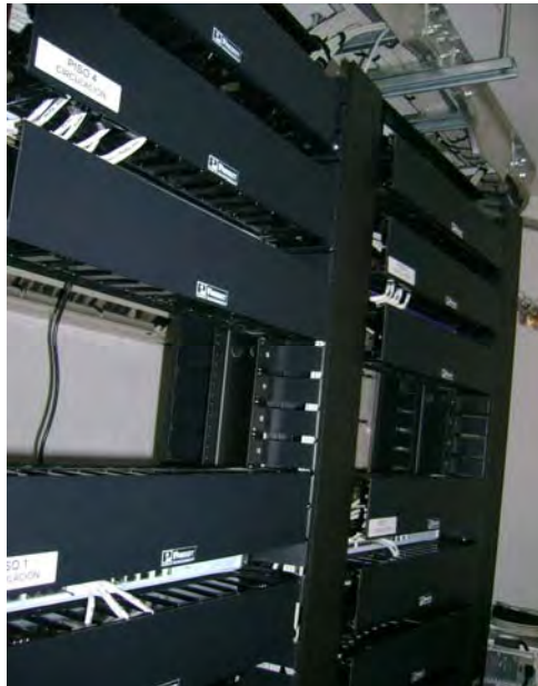
Fotografía 4.4. IDF de primer piso de la BC.
