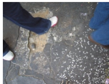
Fig. 1.13 Agujero en banqueta estrecha (Eje Central)
