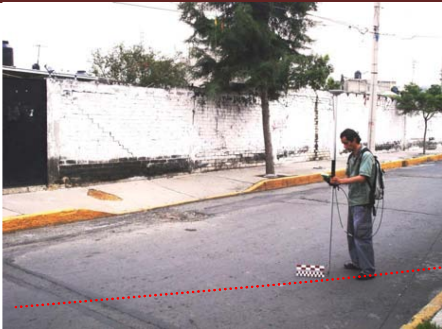
Fig. 2.27 Grieta calle Cenicienta
