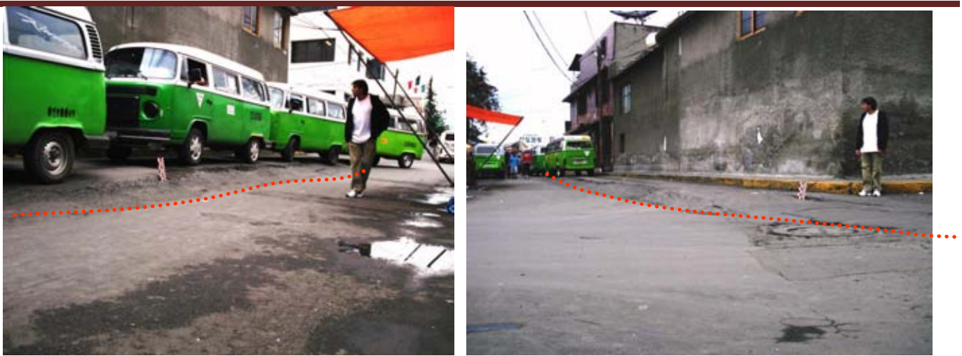
Fig. 2.16 Grieta calle Ramón Torres esquina calle Isabel De Portugal (Nótese el fuerte salto que presenta esa grieta)
