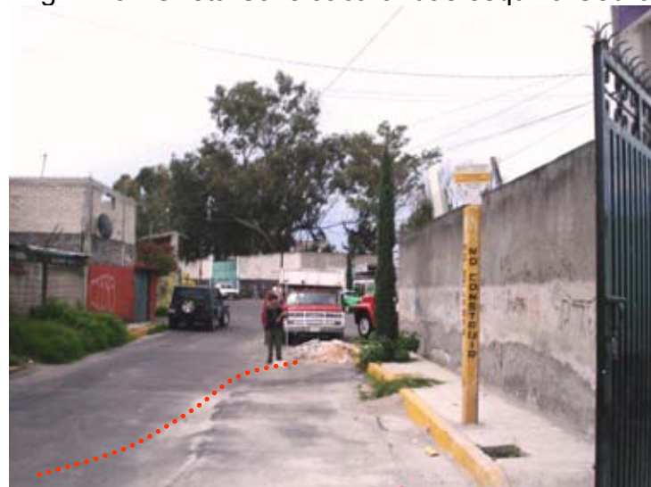
Fig. 2.24 Grieta Calle Sauce esquina Pról. Turba
