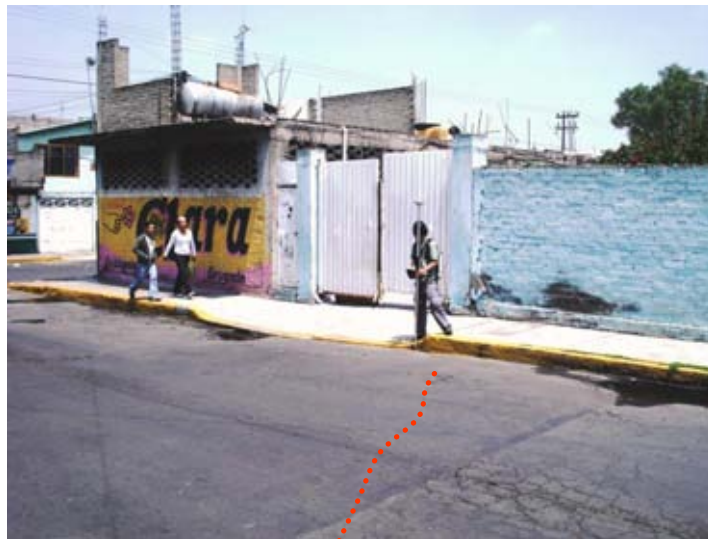
Fig. 2.18 Grieta Calle Del Rosario
