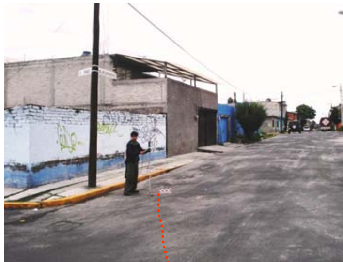
Fig. 2.23 Grieta Calle Jacarandas esquina Cedro
