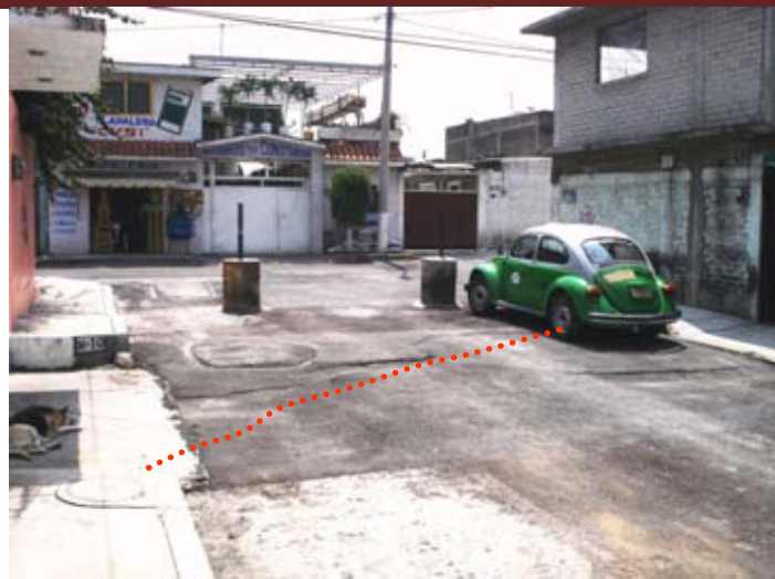
Fig. 2.19 Grieta Calle Flor de Nube
