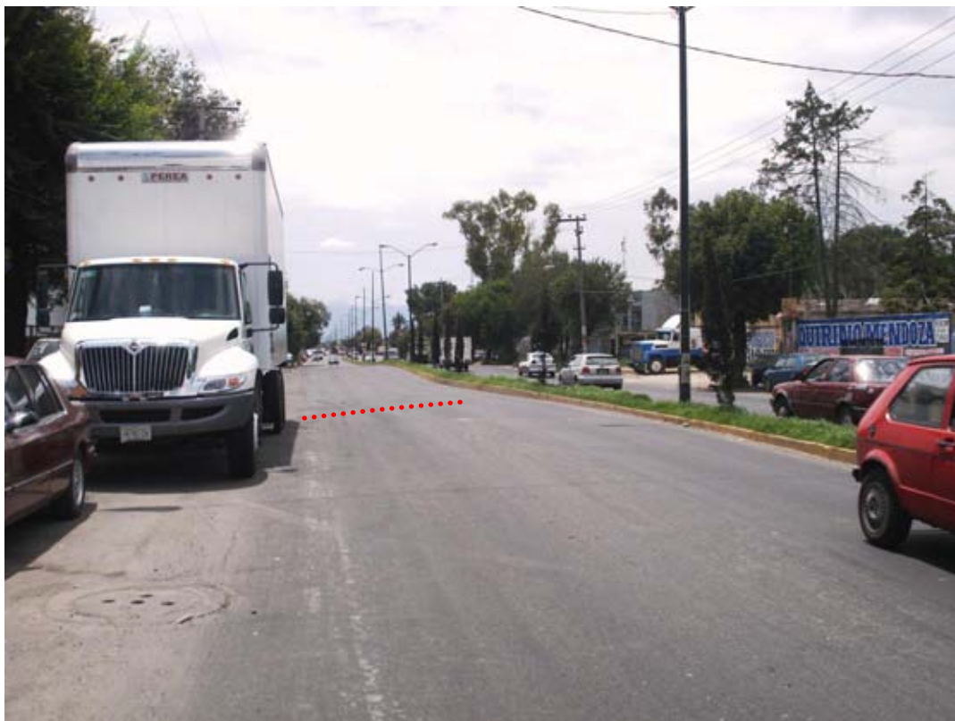
Fig. 2.30 Grieta Unidad Habitacional Zacatenco
