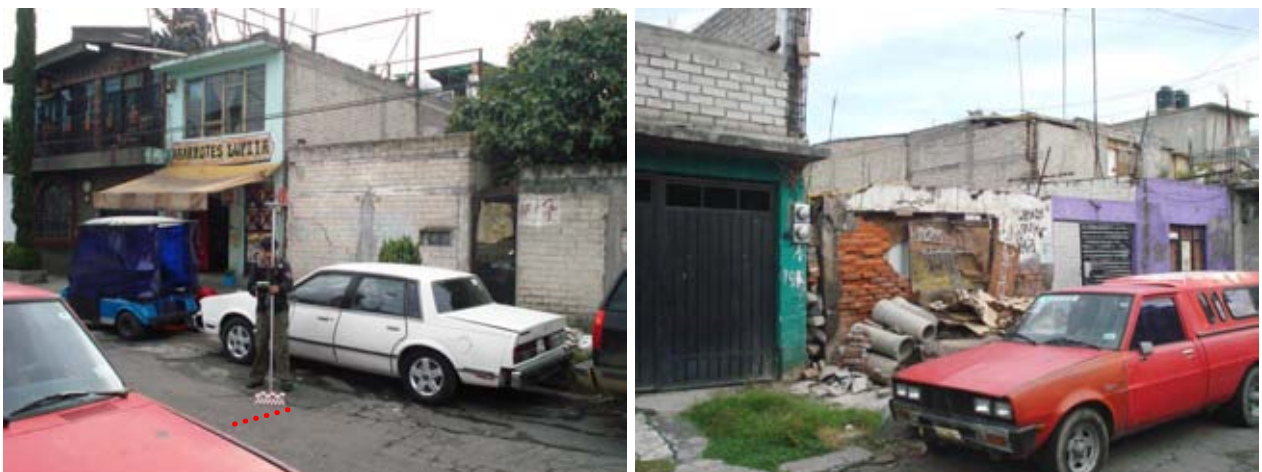
Fig. 2.33 Grieta Calle Maximino Lugo, Colonia las Puertas
