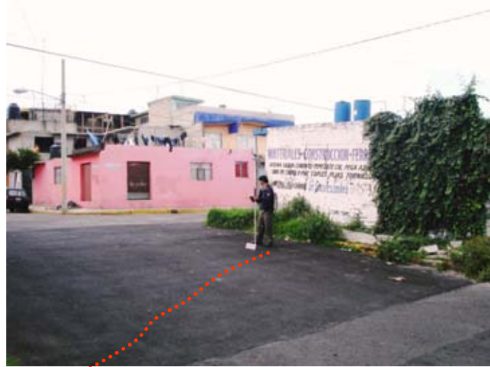
Fig. 2.22 Grieta Calle Pino esquina Jacarandas
