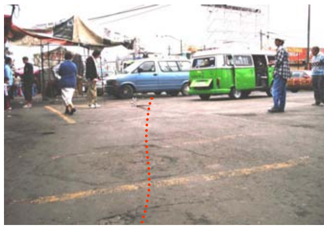
Fig. 2.15 Grieta Avenida Tlahuac esquina con calle Ramón Torres
