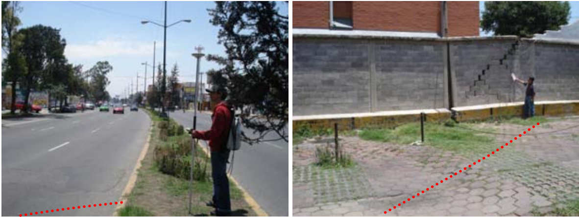
Fig. 2.31 Grieta Tlahuac a la altura de la Unidad Habitacional Zacatenco
