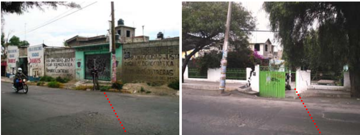
Fig. 2.32 Grieta F.C. San Rafael Atlixco, Colonia las Puertas
