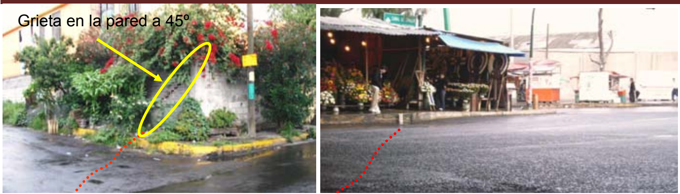
Fig. 2.13 Grieta Calle Zaragoza esquina Libertad y Tlahuac y Canal de Garay
