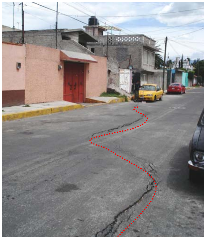
Fig. 2.28 Grieta Calle Revolución
