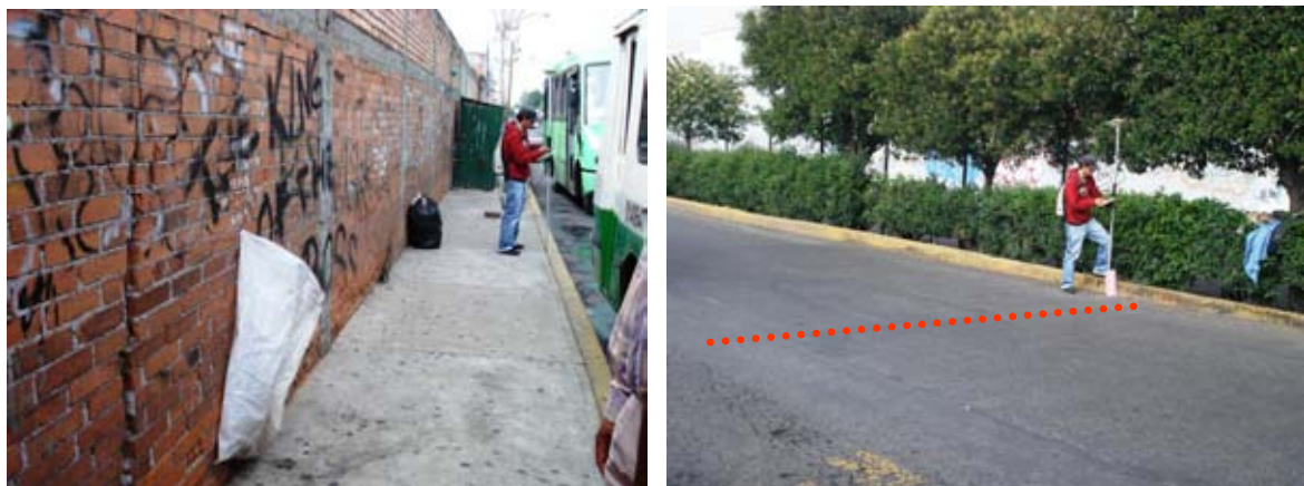
Fig. 2.8 Grieta Avenida 11 esquina Avenida Tlahuac
