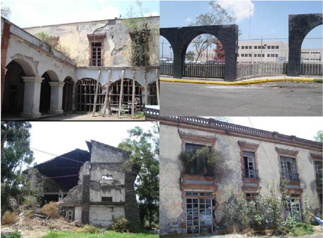
Fig. 2.37 Daños en la Ex Hacienda de San Nicolás en Iztapalapa
