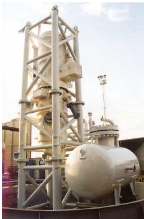
Fig. 1.13 Compresor vertical centrífugo manejado por un motor eléctrico. 33
