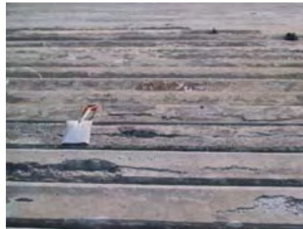
Foto del estado original de las bancas.
