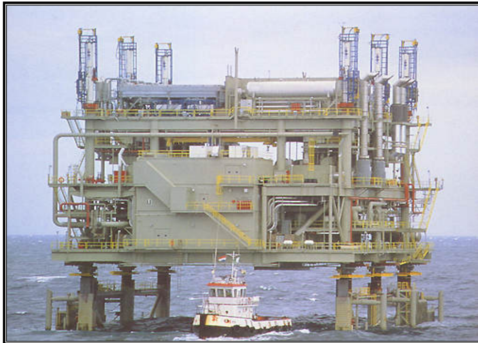
Figura III.9. Instalaciones superficiales marinas.
