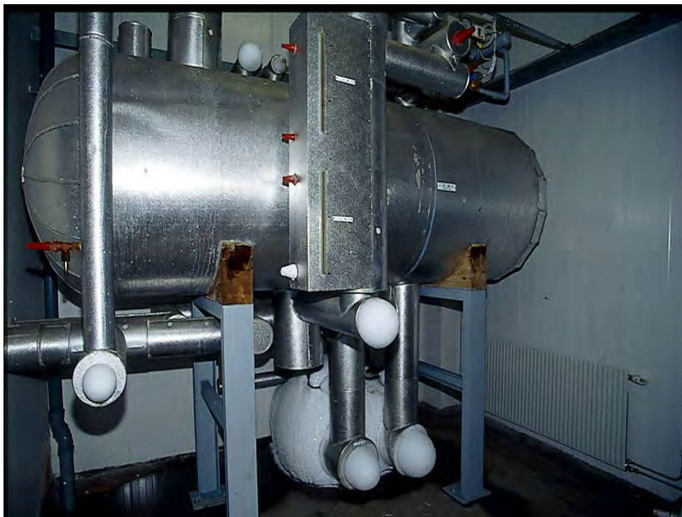
Figura 29. Sistema de recirculación por bombas para CO 2 ( York International Corporation, 1998 ).
