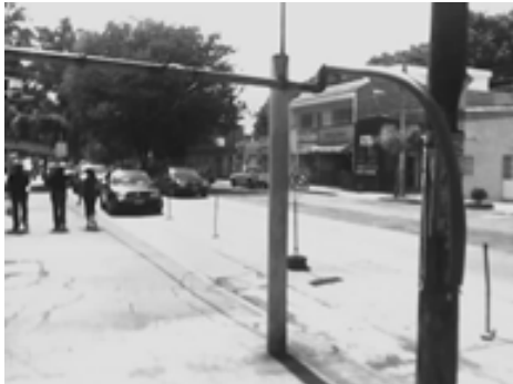
2- Toma de agua para abastecimiento de las pipas en acceso principal.
