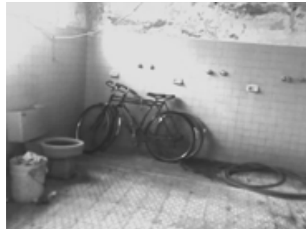
5- Área de aseo personal es ocupada como bodega por falta de espacios.
