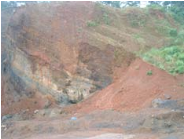
Foto no. 5.- Se observa el banco utilizado para la formación de terracerías, se encuentra ubicado en a la derecha del km. 10+600 a una distancia de 50m. Por su ubicación tan cercaba a la obra, los costos de construcción de terracerías disminuye en forma considerable.
