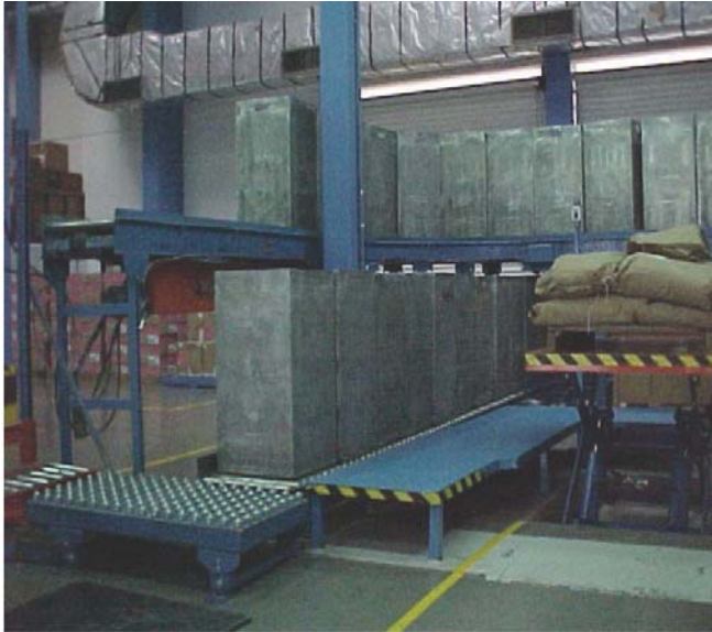
Figura II-4. Transportadores exteriores del irradiador del ININ
