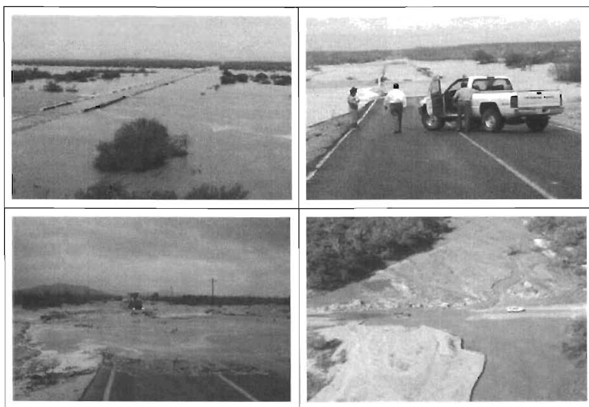
Figura 1. Daños a la infraestructura carretera en Baja California Sur ocasionados por los huracanes Ignacio y Marty. (Fuente: SCT).
