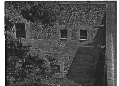
A partir de 1995 se tiene la conciencia de retirar los aplanados de cemento por afectar la constitución del muro, sin embargo se desconoce cuando fueron incorporados y porque no se hizo un retiro total.
