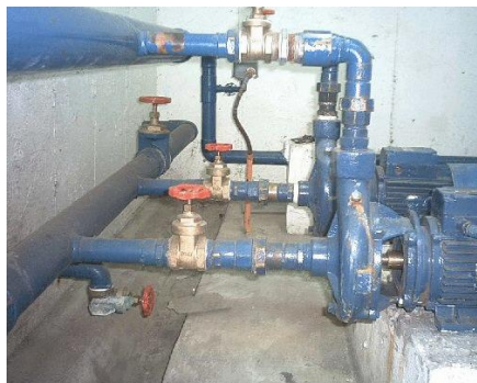
FIGURA 4.12. SISTEMA DE BOMBAS
