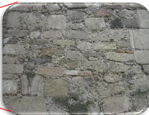
Foto 11. Según un vecino del pueblo, en algún momento nació un árbol en este muro y lo fracturó. Posiblemente esa sea la causa por la que la mampostería que lo conforma se encuentra tan irregular.
