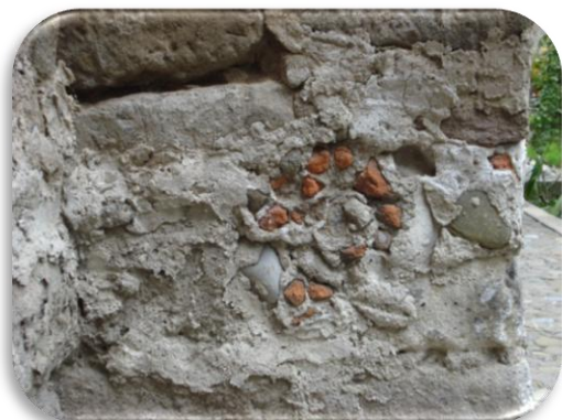
Foto 1. Muestra de distintos materiales que se han injertado en los muros para llenar cavidades.
