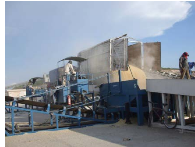
7.13 Caída del grano hacia la tolva principal
