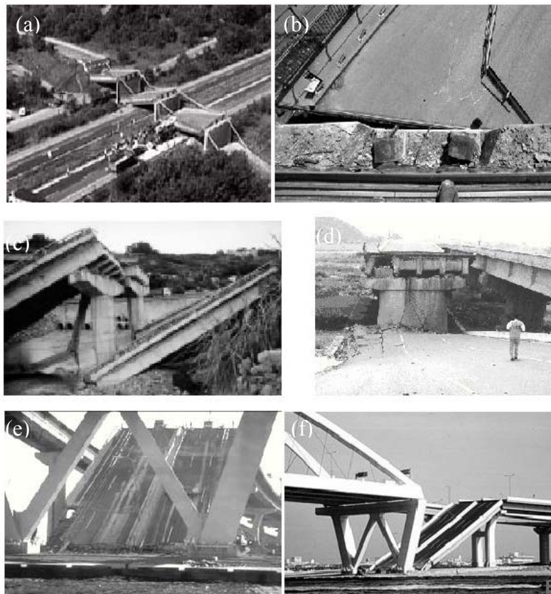
Figura 1.2 Colapso en puentes durante sismos recientes a causa de desplazamientos relativos en sentido longitudinal (Estrada y Reinoso, 2005)
