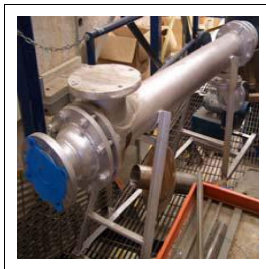
Fig. 3.3 Intercambiador de calor
