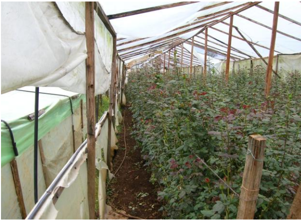
IMAGEN No. 12. Mal estado de la cubierta plástica y estructura en un invernadero rustico
