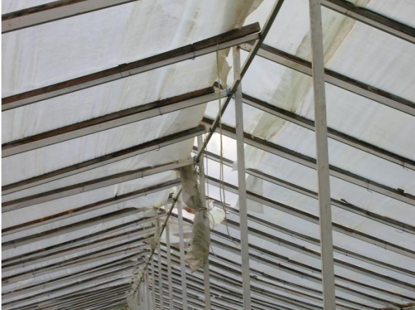
IMAGEN No. 14. Estructura tubular metálica en invernadero semitécnico con deficiencias técnicas.
